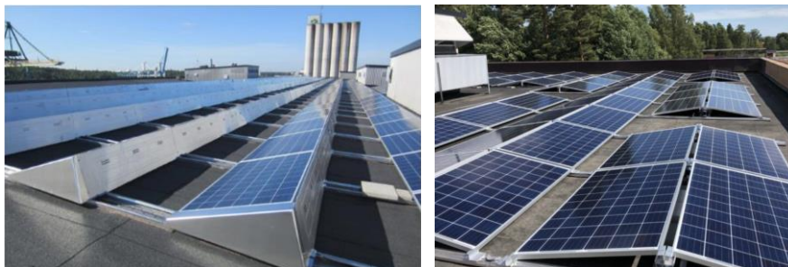
Figur 3 Upplutade moduler (vänster) och moduler installerad i öst&väst system (höger). Observera plattorna bakom upplutade moduler i vänstra bild
