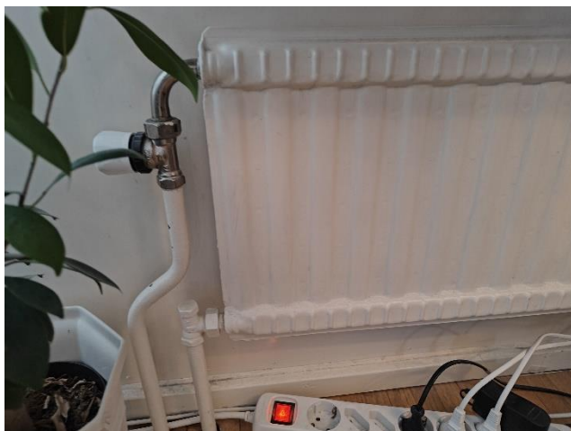
Figur 14. Panelradiator med ventil utan termostat – övervägande denna typ av installation i föreningen
