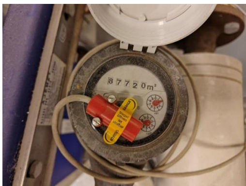
Figur 11 - Vattenmätare varmvatten som inte statistikförs
